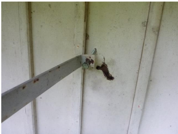
Kuva 39. Kattotikkaiden kiinnitys on puutteellinen ollen osin irtonainen.
