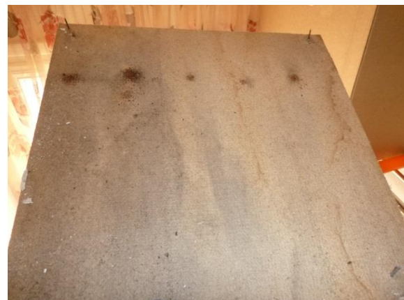
Kuva 76. Kattopaneelin taustapinnassa kosteusjälkiä.
