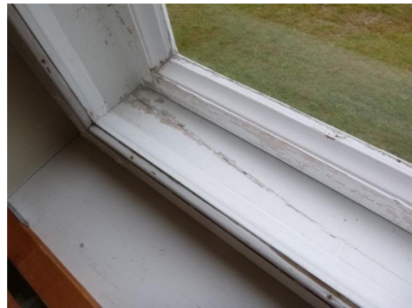
Kuva 46. Kosteusjälkiä ikkunanpuitteessa ja karmissa.
