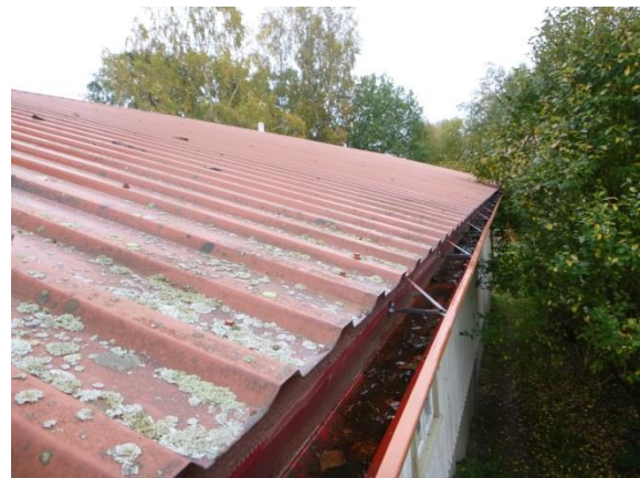
Kuva 87. Räystäskourussa lounaissivulla on havaittavissa lievää lammikoitumista.
