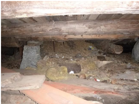
Kuva 10. Alapohja on romahtanut eteisessä suuren luokkahuoneen oven kohdalla vanhan tulisijan perustusten etupuolella.
