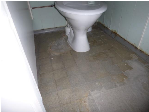
Kuva 70. Poikien wc-tilan pintamateriaalit ovat kosteusvaurioituneet.
