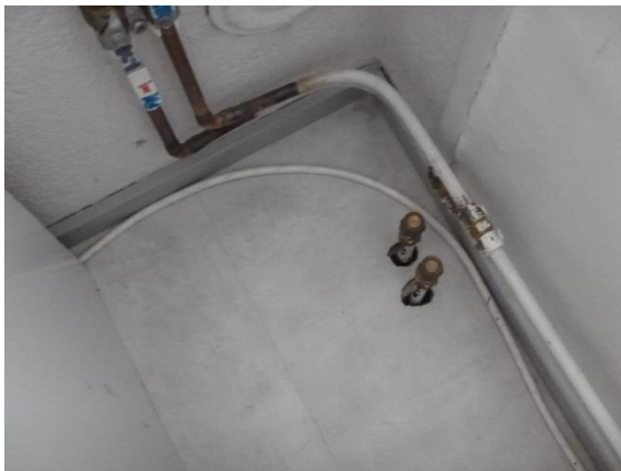
Kuva 68. Tiivistämättömiä läpivientejä opettajien taukotilassa.
