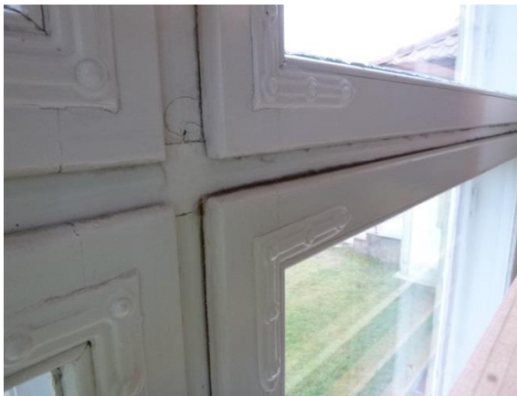
Kuva 45. Sisäpuite on epätiivis.
