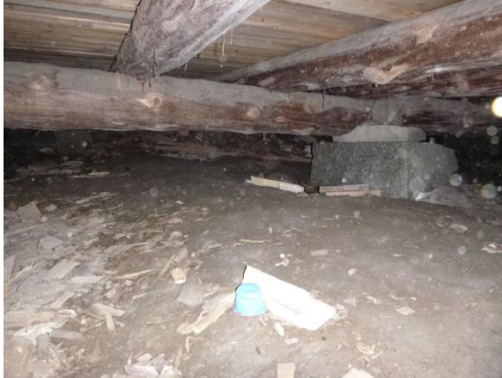
Kuva 2. Ryömintätilassa on roskaa ja rakennusaikaista jätettä.
