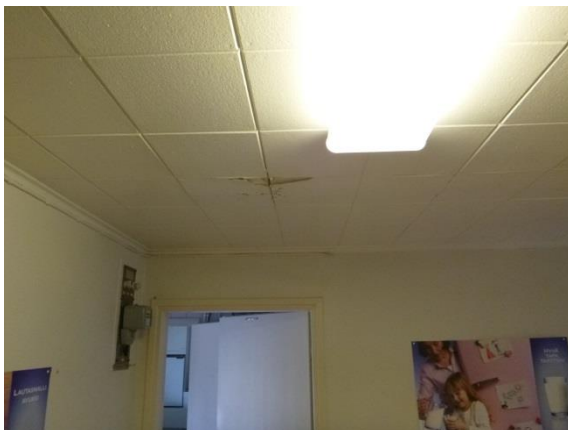
Kuva 58. Kosteusjälkiä keittiön eteisen katossa
