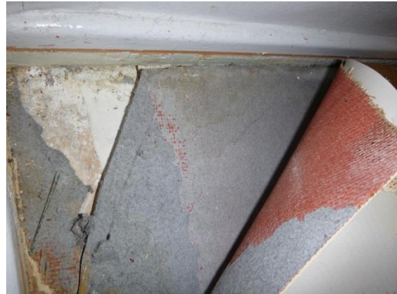
Kuva 81. Muovimaton alapuolella linoleum-matto ja aluspahvi.
