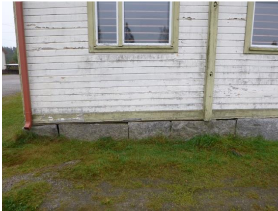
Kuva 31. Maanpinta on paikotellen noussut myös lounaissivulla. Kivijalassa ja julkisivuverhouksessa on havaittavissa painumista.
