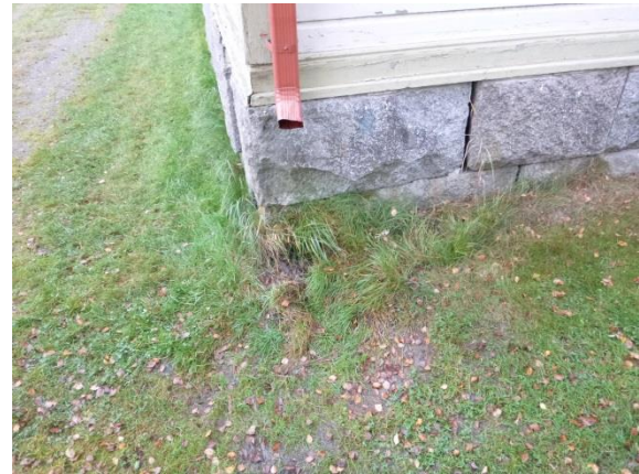
Kuva 32. Syöksytorstesta tuleva sadevesi on ohjattu kivijalan vierustalle.
