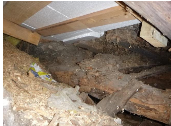
Kuva 11. Lahonnutta alapohjaa on korjattu eteisen kohdalla.
