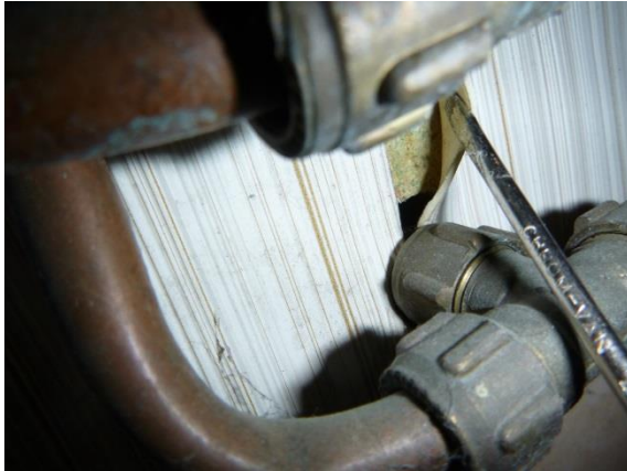
Kuva 60. Pesuhuoneen suihkun kohdalla olevat seinäläpiviennit ovat tiivistämättömiä.
