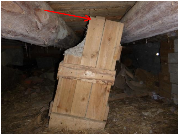
Kuva 6. Lattian kannattajan betonituki kallistunut pois paikoltaan nuolen suuntaan.
