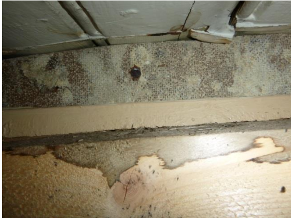
Kuva 73. Hormin pintarakenteiden kosteusjälkiä.
