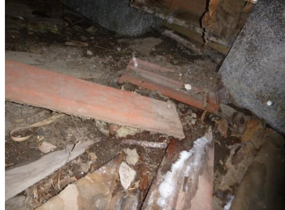
Kuva 9. Runsaasti mikrobivaurioitunutta puutavaraa eteistilan kohdalla.
