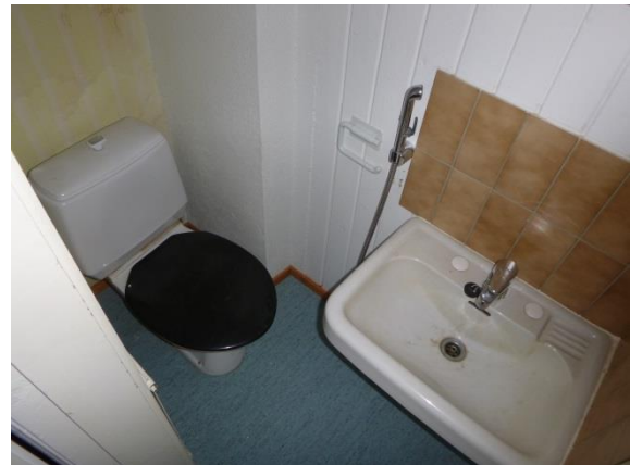
Kuva 63. Yleiskuva toisen kerroksen wc-tilasta, wc-istuin vuotaa läpi.
