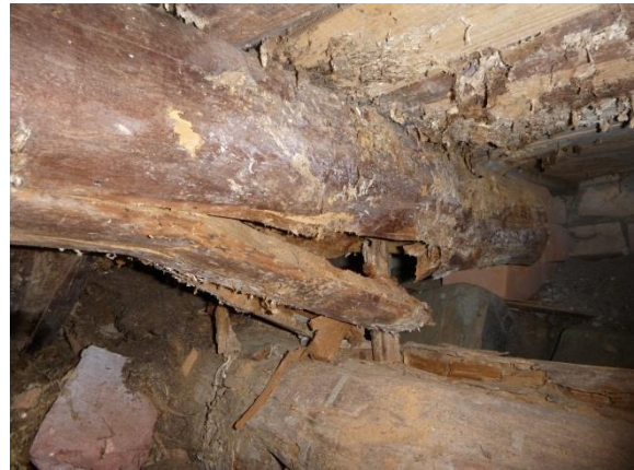
Kuva 15. Lahovaurio pääpalkissa ja silminnähtävää mikrobikasvustoa suuren luokkahuoneen purettujen tulisijojen perustusten edustalla.
