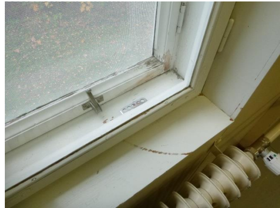
Kuva 44. Kosteusjälkiä ikkunanpuitteessa ja karmissa.
