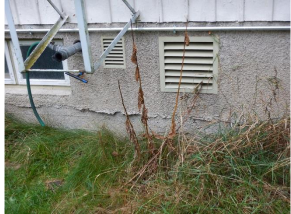
Kuva 38. Sokkelin rappaus on vaurioitunut maanpinnan läheisyydestä.
