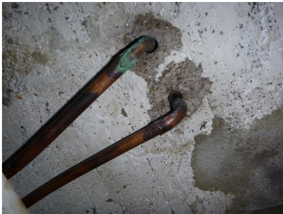
Kuva 90. Vesijohdotputken liitoskohdassa vuotojälkiä.
