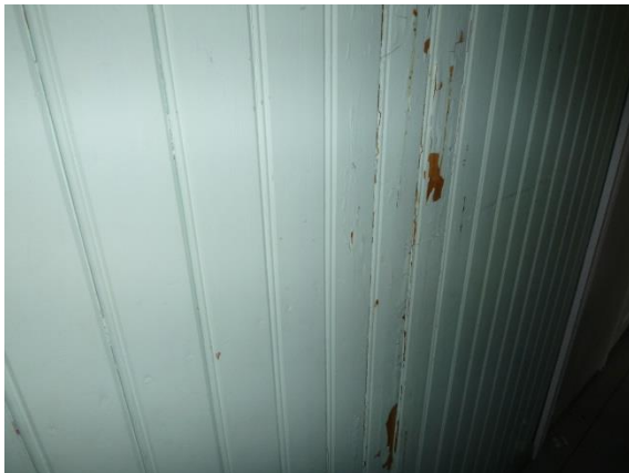
Kuva 64. Vanhoja kosteusjälkiä toisen kerroksen seinä-paneelissa wc-tilan kohdalla.
