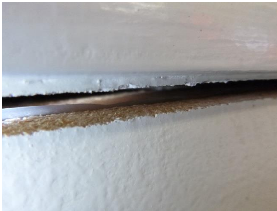
Kuva 47. Sisäverhouslevyn ja ikkunalaudan välinen liitos ei ole tiivis.
