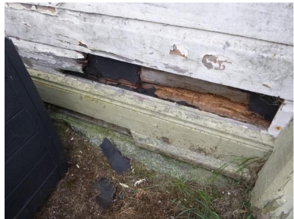
Kuva 28. Lahovaurio julkisivussa koillispuolella.
