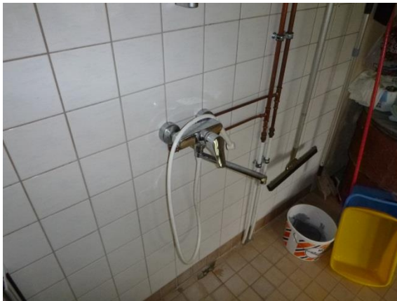
Kuva 94. Pesutilan suihkuhana. Vesijohtoja on osin uusittu.
