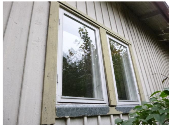
Kuva 40. Ikkunan vesipelti kallistuu sisäänpäin alareunastaan. Kuva lounaisseinustalta.
