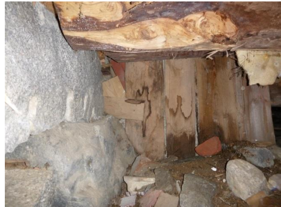
Kuva 7. Kosteusvaurioitunutta muottilaudoitusta keittiön puulieden kohdalla.
