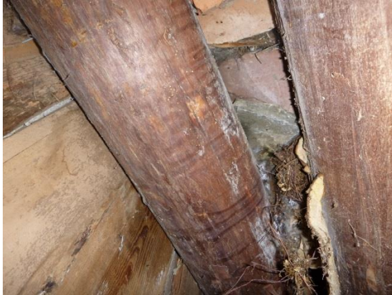
Kuva 8. Lattiankantajassa on havaittavissa näkyvää mikrobikasvustoa keittiön puulieden kohdalla.
