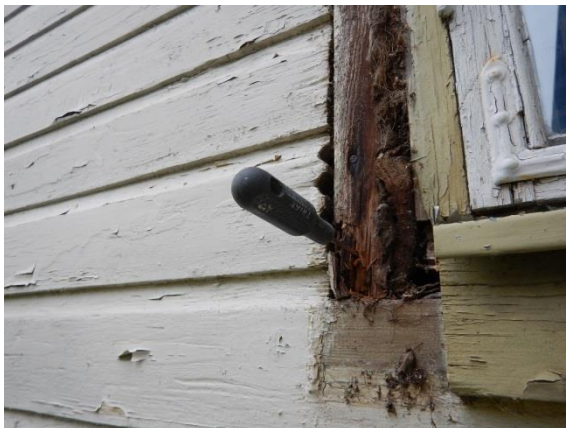
Kuva 35. Etelä-koillispäädyn sivuluokan ikkunan vuori- laudan alla havaittiin pitkälle edennyttä lahoa ikkunankarmissa.
