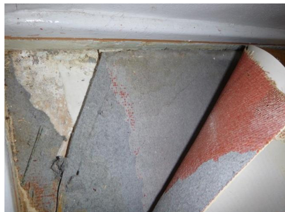
Kuva 79. Muovimaton alapuolella linoleum-matto ja aluspahvi.
