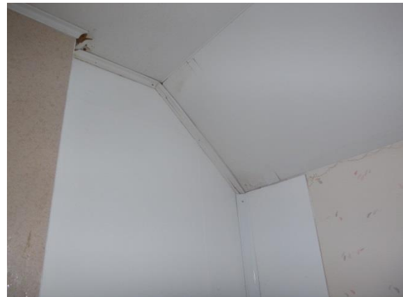
Kuva 65. Vanhoja vuotojälkiä yläkerran huoneessa.
