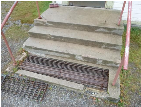
Kuva 27. Sisäänkäynnin betoniportaat ovat rapautuneet ja lohjonneet.
