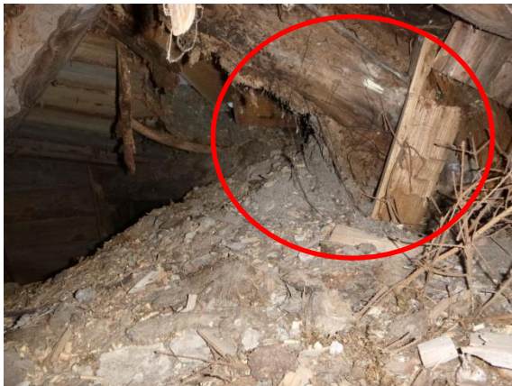
Kuva 12. Lahonneessa niskahirressä havaittavissa sienirihmasto.
