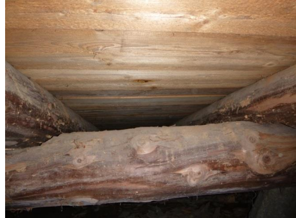
Kuva 3. Rossilaudoitus on uusittu jossain vaiheessa suuren luokkahuoneen kohdalla.
