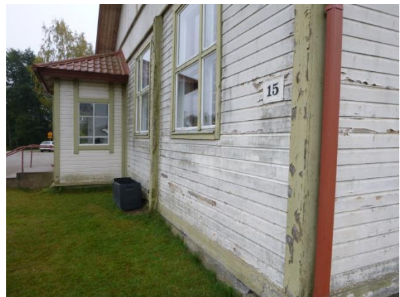
Kuva 30. Maalipinnassa on havaittavissa vaurioitumista.
