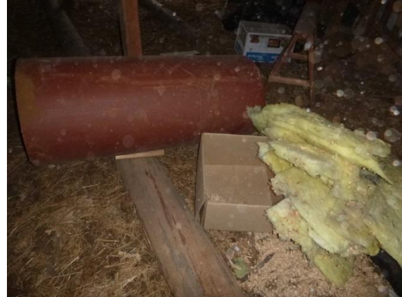
Kuva 85. Vanha paisuntasäiliö ullakolla.
