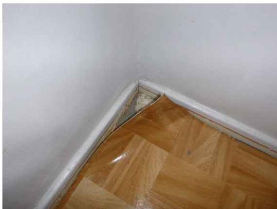
Kuva 78. Rakenneavaus 7, sivuluokka. Muovimatto on paikoin heikosti kiinni alustassa.
