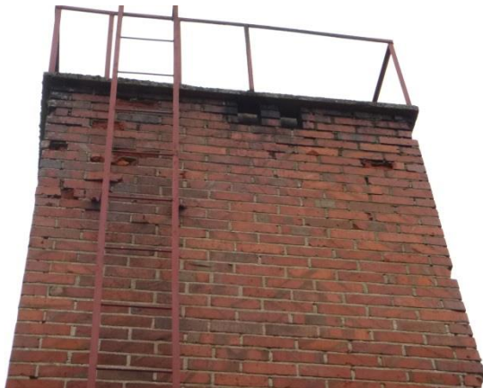
Kuva 88. Rapautuneita tiiliä laajennusosan piipussa.
