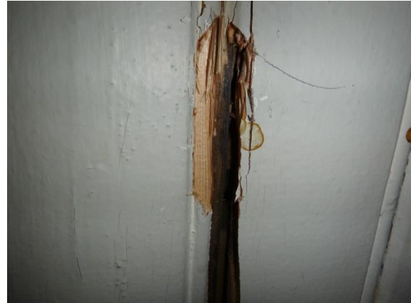
Kuva 74. Paneloinnissa on kosteuden aiheuttamaa vauriota.
