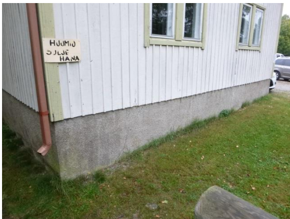
Kuva 41. Halkeama sokkelin rappauksessa laajennusosan päädyssä
