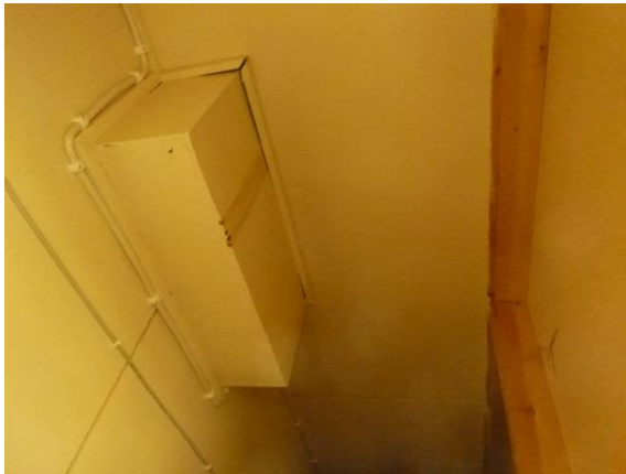
Kuva 66. Suuremman luokkatilan yläkaappien sisäpuolella olevia kosteusjälkiä yläpohjassa.
